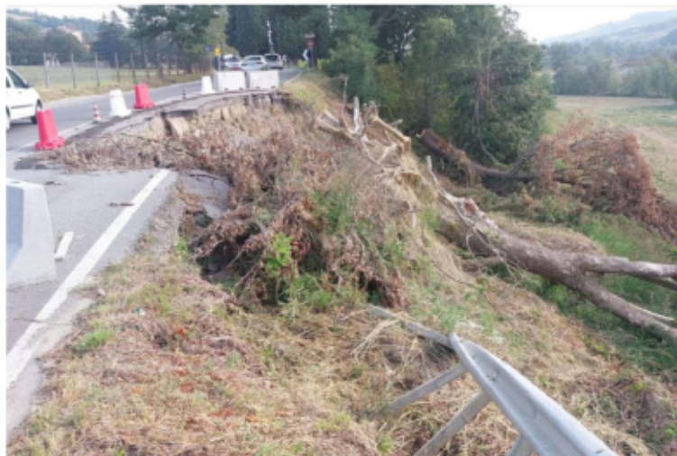
I lavori in corso in due tratti diversi della Sp3 del Rabbi
